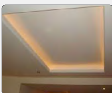
Plafond suspendu staff avec luminaires intégrés
