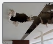
Plafond suspendu avec isolant phonique
